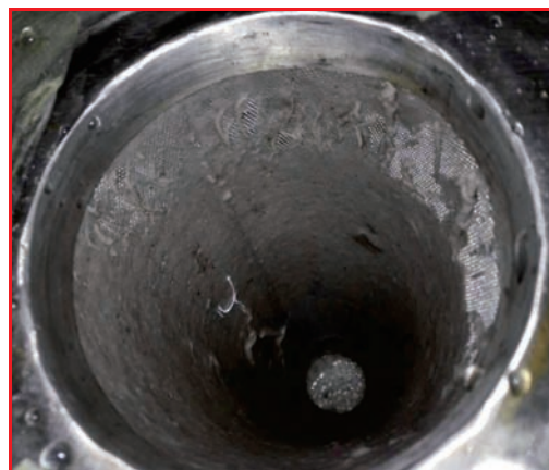
图4 水溶纸堵塞硼回收系统循环泵入口过滤网
