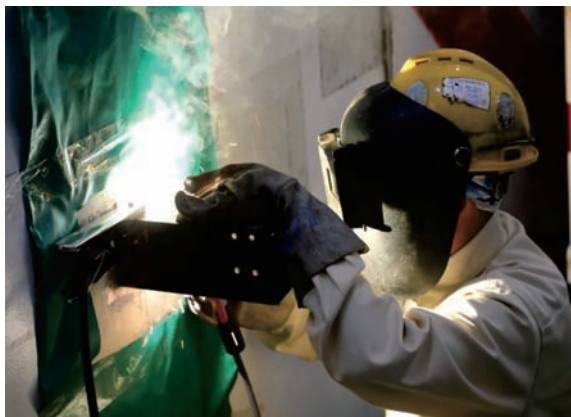
“玲龙一号”全球首堆核岛安装工程开工， 安装人员焊接反应堆厂房管道支吊架
